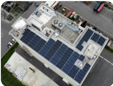
中港廠 - 屋頂型太陽能發電系統 裝置容量 137.78 Kw
