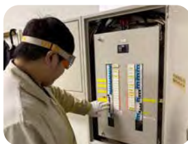
緊急切斷電源
